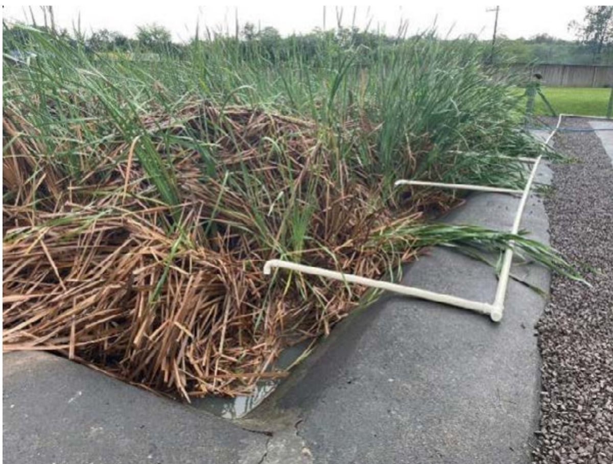
Figura 3. Adequação da entrada da Lagoa com distribuição uniforme do efluente através de quatro pontos. Foto: Juliana Figura da Rosa.
